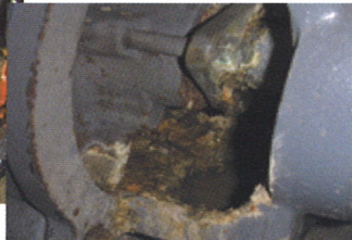
冷却水ポンプ軸受でのスケール障害
