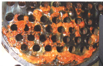
熱交換機でのスケール・さび障害
