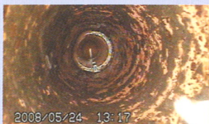
②洗浄剤投入約2ヶ月後の状況 金型洗浄後の内視鏡写真。表層の付着物が除去され、下層部のスケールが見え始めた。金型洗浄後チラー冷水槽の水を入れ替えAWP(アルカリイオン水)10%投入。
